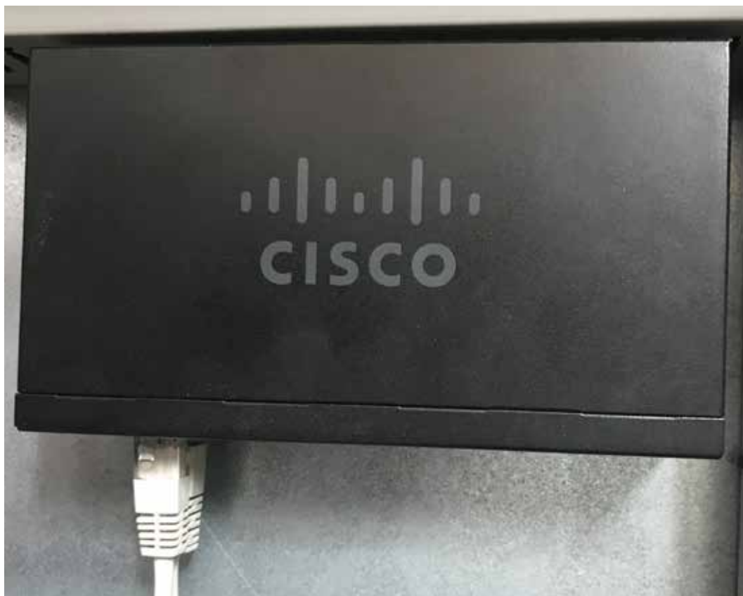
Obr. 16 – Detail připojení části komunikace k hybridnímu systému – switch
